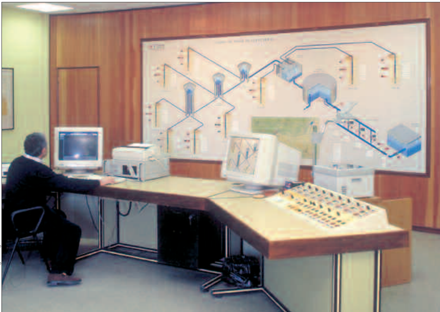
Sala de control del campo de pozos de Fuencarral. Panel sinóptico.
